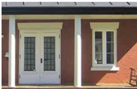
Porte double en bois et fenêtre à manivelle imitant une fenêtre traditionnelle à six carreaux
