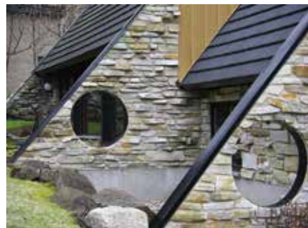
Contreforts formés par le prolongement des lignes de toiture jusqu'au sol et percés de cercles
