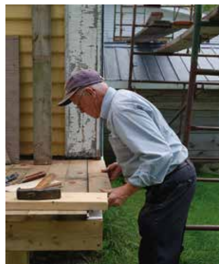
Les artisans et experts en construction sont en mesure de restaurer ou de reproduire des composantes anciennes que l'on ne peut trouver sur le marché.
