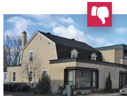
Une maison à mansarde ne devrait jamais être agrandie vers l'avant, car la volumétrie du bâtiment est irrémédiablement altérée.
